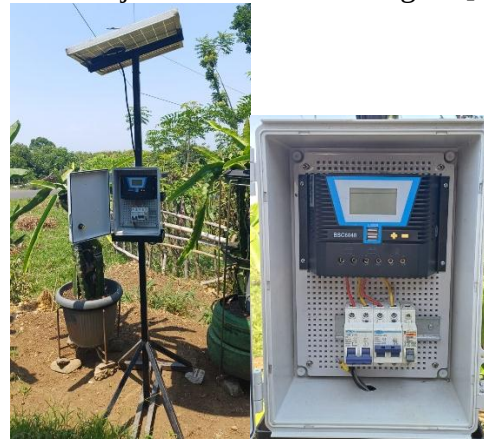
Gambar 4. Pembangkit Listrik Tenaga Surya (PLTS)
